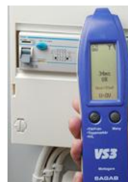
Tester udkoblingstiden på fejlstrømsafbrydere.
